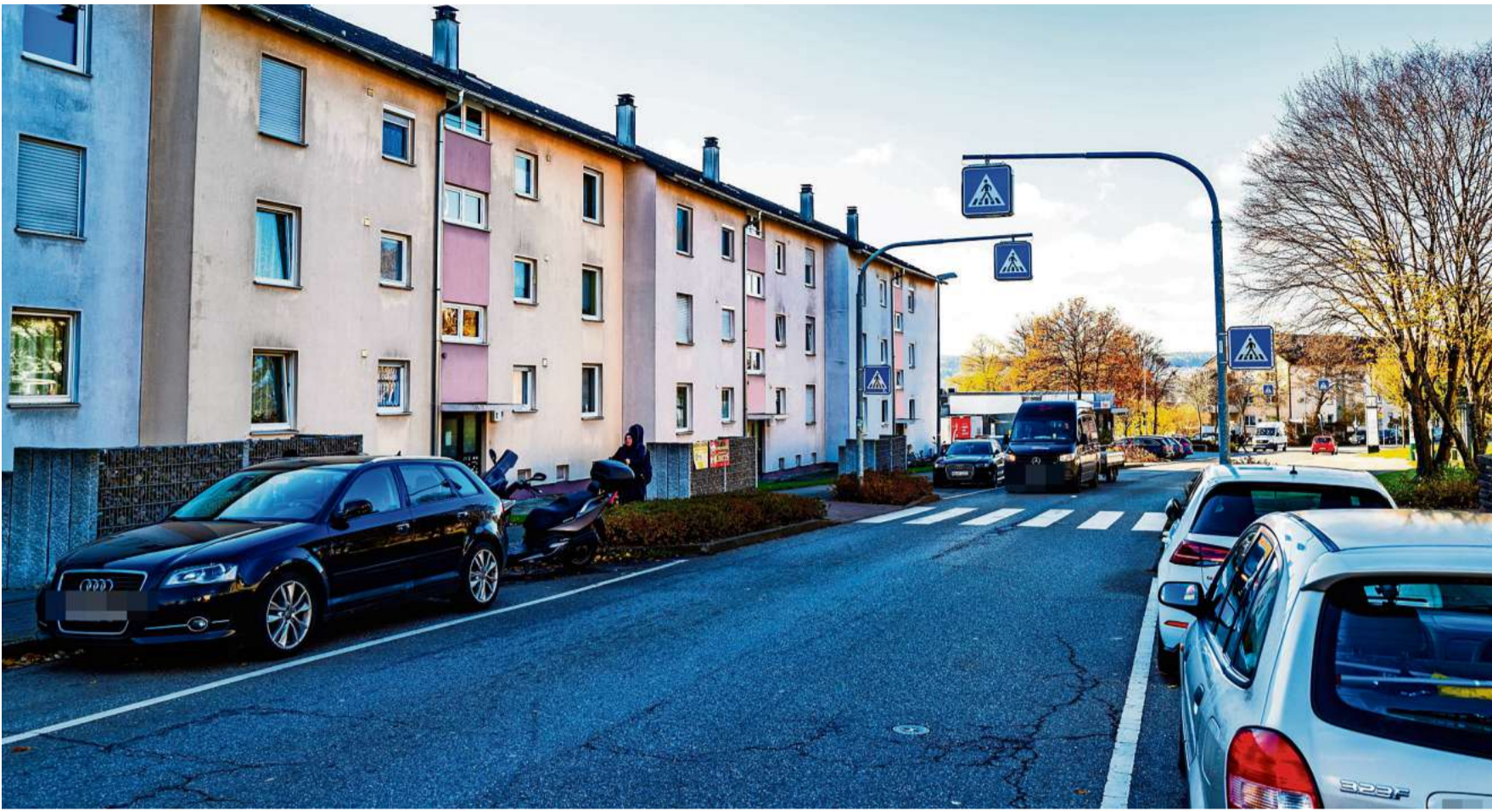
Risse und Schlaglöcher prägen das Bild der Heinz-Schnauffer-Straße in Heumaden.
