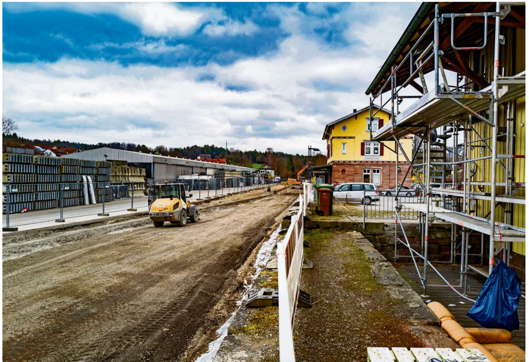
Alte Gleise raus, neue Schienen rein: Beim Alten Bahnhof in Althengstett bietet sich ein ungewöhnliches Bild.
